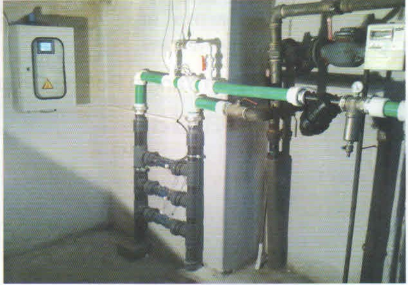
Gümüş-Bakır iyonizasyon teknolojisi, tesisin su sirkülasyon sistemine kontrol panosu ve elektrot entegre edilerek yalnızca 1 günde kuruluyor
